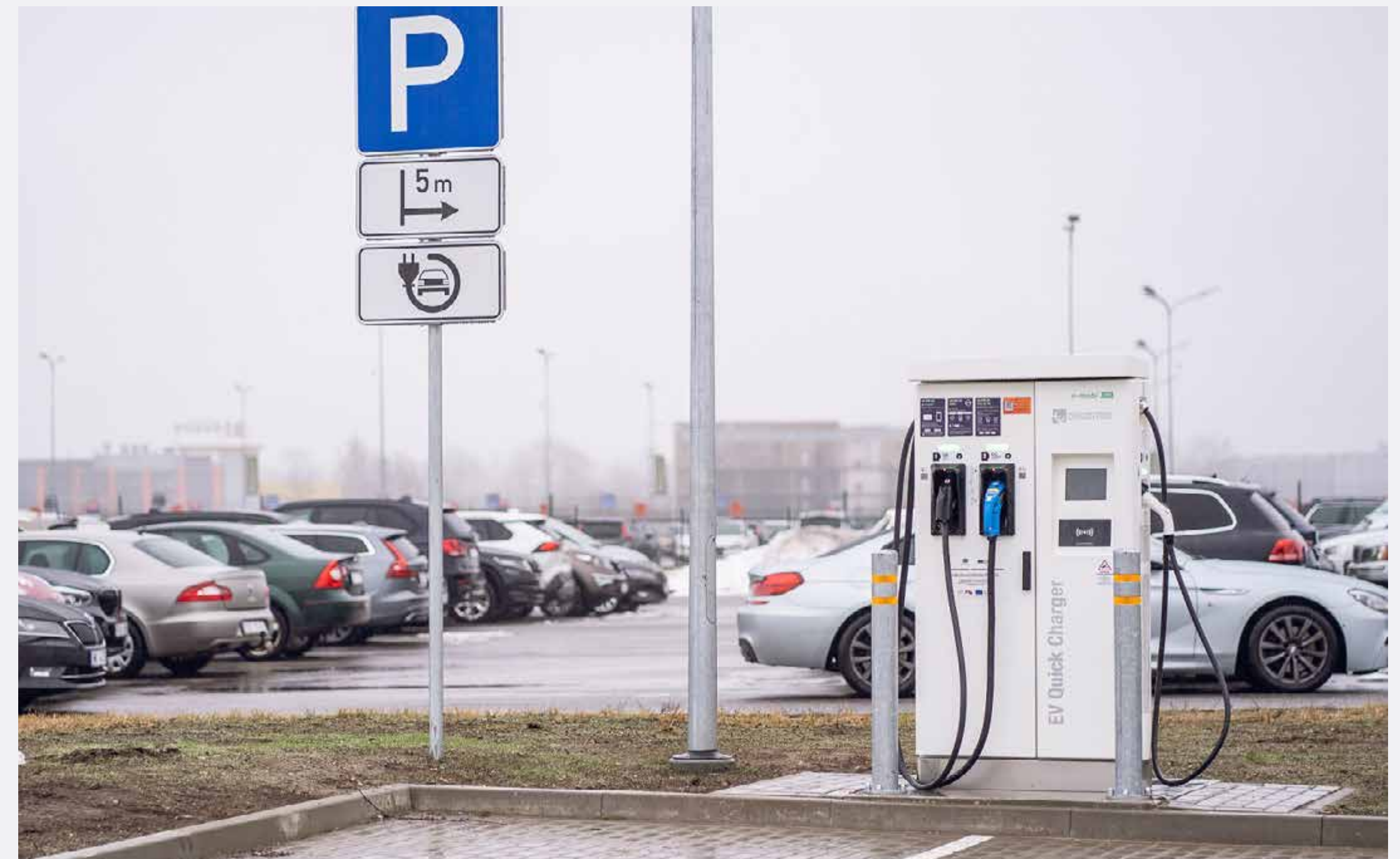
7.attēls. Elektroautomašīnu uzlādes stacija.
